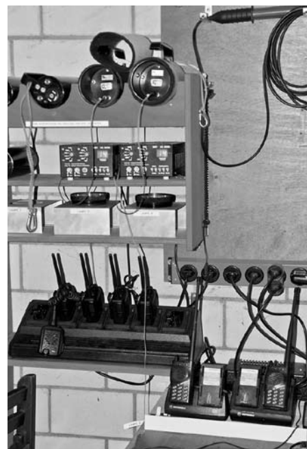
Griffbereit für den Notfall – Funkgeräte im Kommandohaus in Obermeilen
